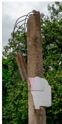
Poste quebrado na Avenida das Tulipas
