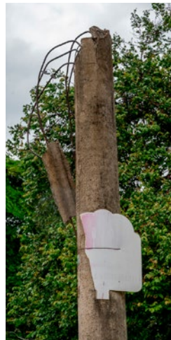
Poste quebrado na Avenida das Tulipas
